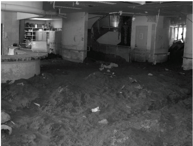
写真 3 老人ホーム内部の土砂堆積
