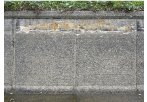
写真1 凍害を受けた水路
