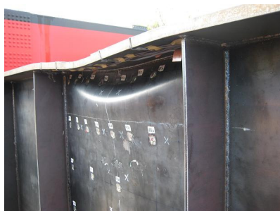
図-4 崩壊状態 供試体 PG20
