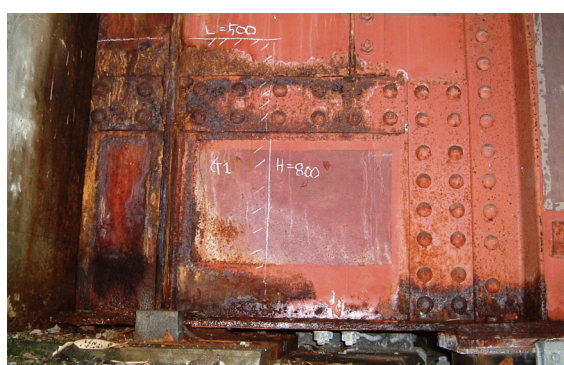
写真-1 A2橋台部のウェブ・下フランジ切断取替部の再劣化
