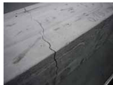
写真2 ひび割れの生成
