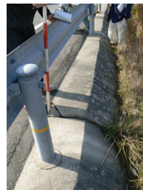
図-3 路肩部のずれ
