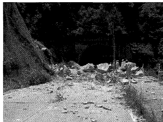
写真-2 道路面の落石状況 (広島県写真)
