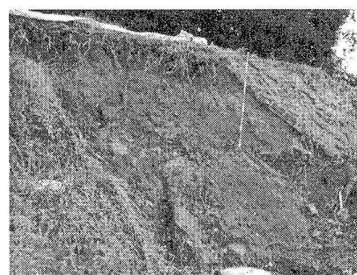
写真-1 岩国市下の崩壊状況
