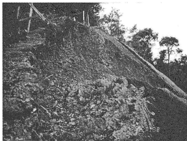
写真-2 滑落崖の状況
