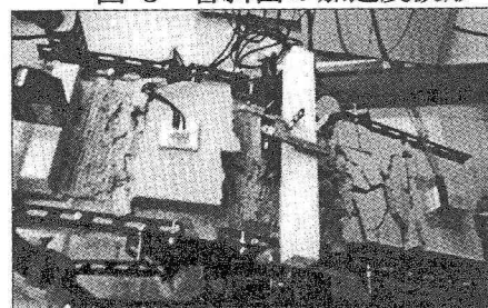
図5 発生したクラック
