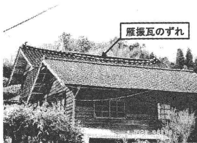
写真-2 雁振瓦のずれ (倉吉市横手)
