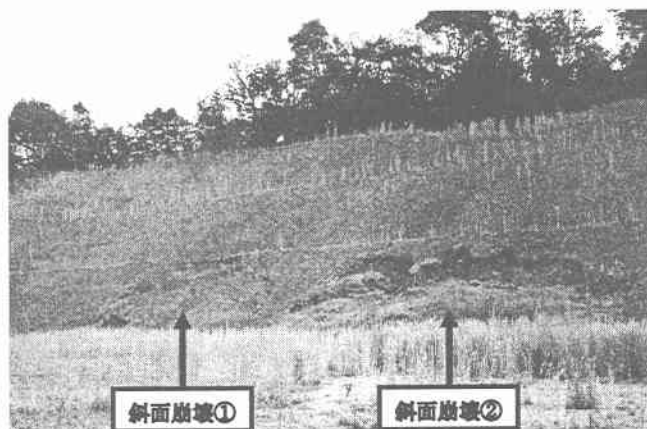
写真-1 斜面崩壊の全景
