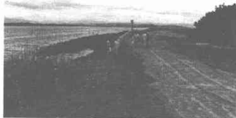
図-5 弓ヶ浜干拓の干拓堤防の被害
