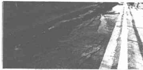
図-3 竹内工業団地水取路内の噴砂
