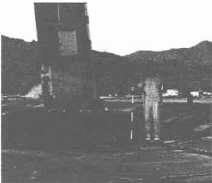
図-2 カニかご護岸の被害
