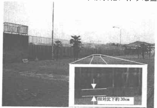
写真-3 米子市安倍下水処理場の地盤の沈下
