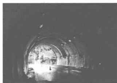
写真-1 坑口部漏水状況
