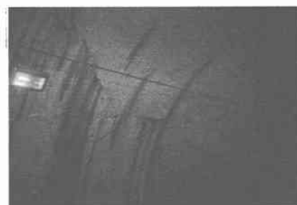
写真-4 トンネル中央部放射状亀裂
