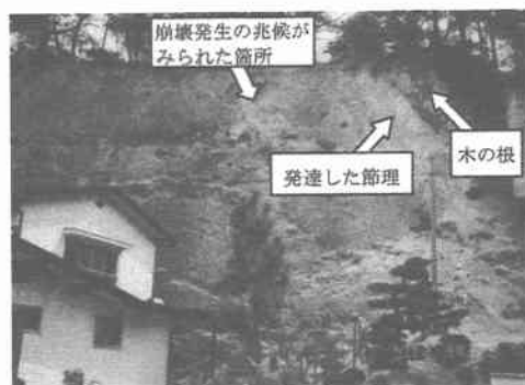
写真-1 岩国市錦見における斜面崩壊
