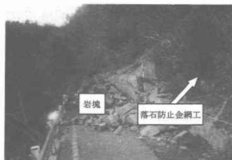
写真-2 東和町油宇における岩盤崩壊
