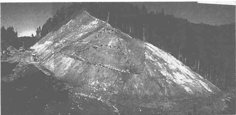
写真－1 崩壊斜面の全景
