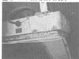
図-2 トンネル照明器具腐食
