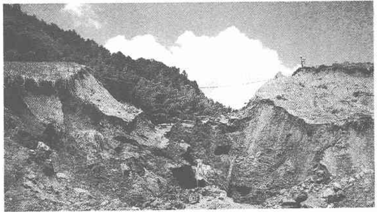
写真—2 江良溜池の決壊状況
