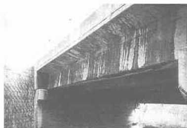
写-1 水切りが無いための汚れ
