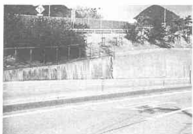
写-2 設置物による汚れ
