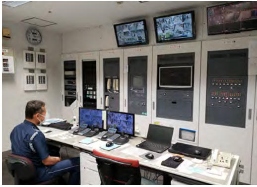
写真-13 防災監視盤による確認状況
