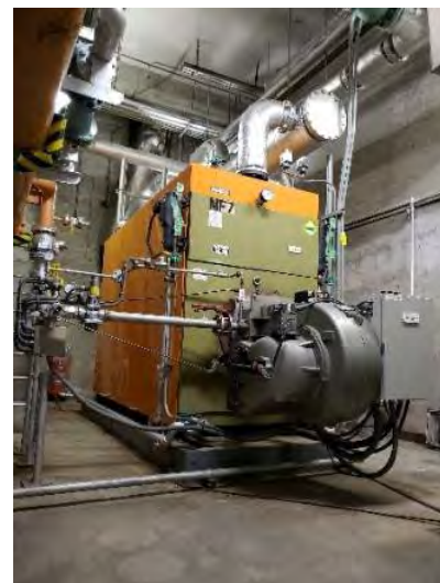
写真-8 暖房熱源 (ボイラ)
