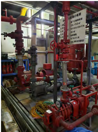
写真-14 消火栓ポンプ等
