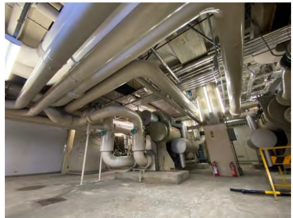
写真-7 冷房熱源 (ターボ冷凍機)
