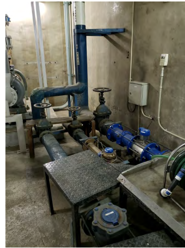
写真-9 給水本管引き込みメーター廻り
