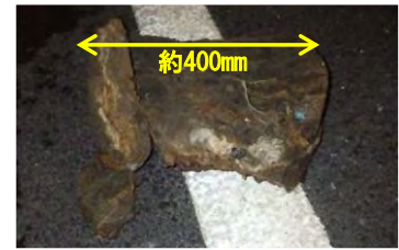
写真-4 撤去した遊離石灰
