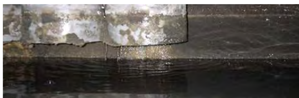
写真-7 沈砂槽水面と排水管Iの隙間状況
