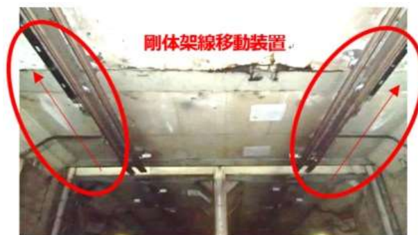
写真-8 剛体架線移動装置
