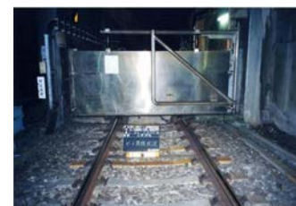
写真-5 丸ノ内線御茶ノ水坑口防水ゲート
