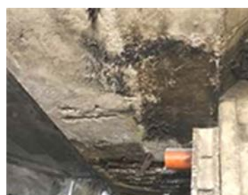
写真-4 躯体の劣化事例
