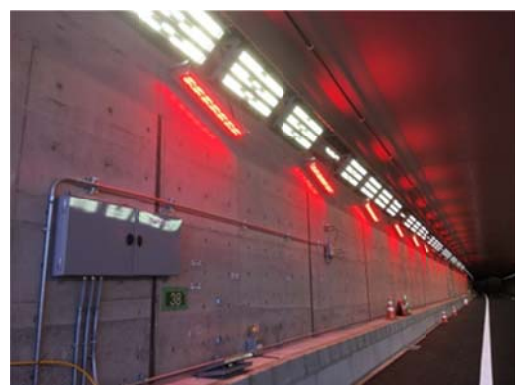
写真-1(b) 警告灯照明の点灯状況（トンネル坑内）
