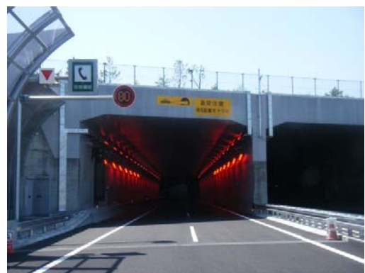
写真-1(a) 警告灯照明の点灯状況（トンネル坑口手前より）
