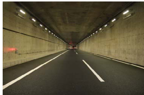
写真-8(b) 視線誘導灯の点灯状況 （火災発生時等：赤色点滅）
