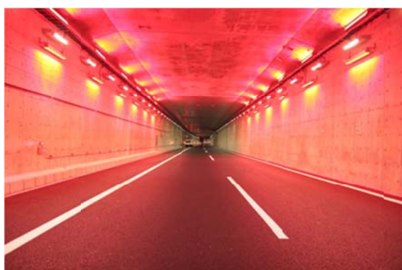
写真-2(b) 警告灯照明の点灯状況（火災発生時等）
