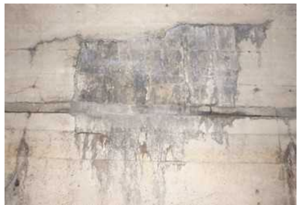
写真-6 覆工表面洗浄後の汚れ除去不可能箇所
