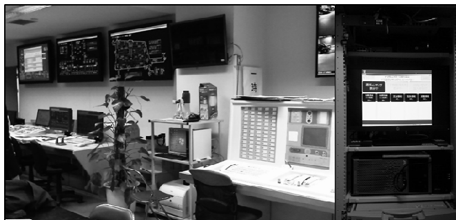
写真-4 防災センター内と機器収容ラック内の表示状況
