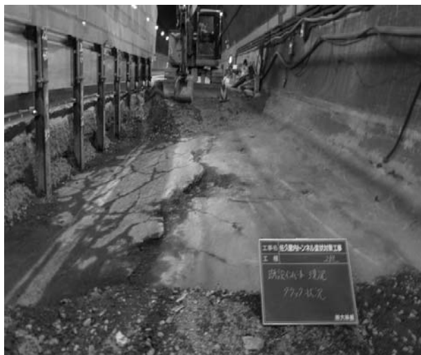
図-9 インバート損傷状況
