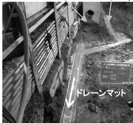
図-10 上流側からの湧水
