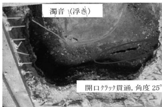
No2ピット インバート損傷
