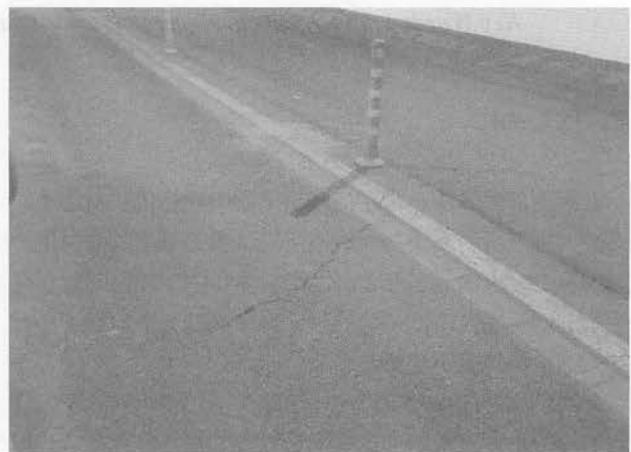
写真-1 アスファルト舗装面に生じた亀裂
