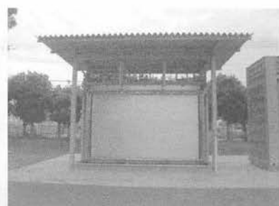
写真-10 防水シャッター
