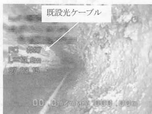
図-4 多条布設不可の不良管路
