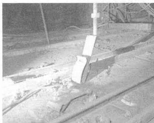
写真-2 下地材(ハンガー)の脱落【天井内目視】
