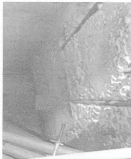
写真-3 躯体のジャンカ、鉄筋の露出【天井内目視】
