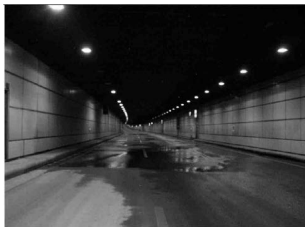
写真-1 構造目地からの漏水の状況（地震後）
