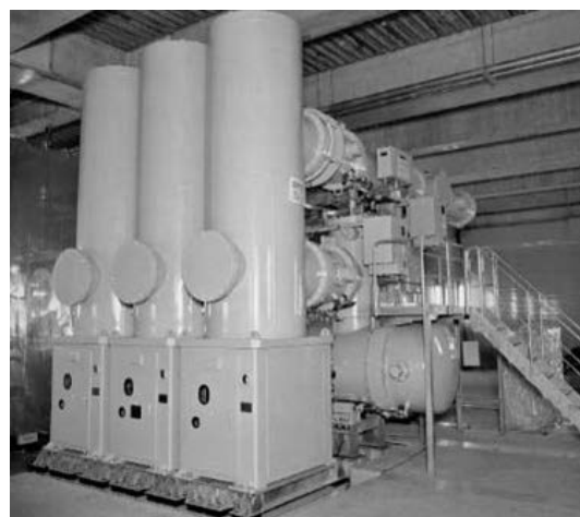
写真-4 東京電力（株）新豊洲変電所 地下変電設備
