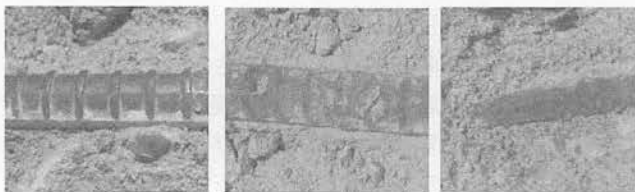
写真-5 鉄筋の腐食グレード (II~IV)
