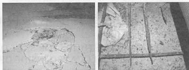
写真-2 中床版上面被りコンクリート剥離と激しい鉄筋腐食
