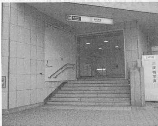
図-2 駅出入口の嵩上げと防水扉
