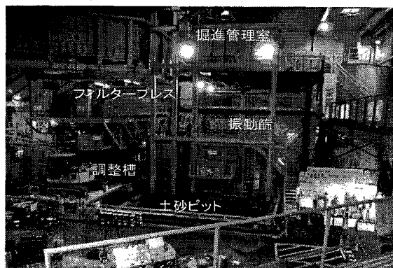
写真-1 処理プラント（立石立坑）
