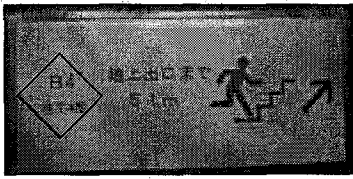
写真-2 避難誘導及び 地下階案内板
