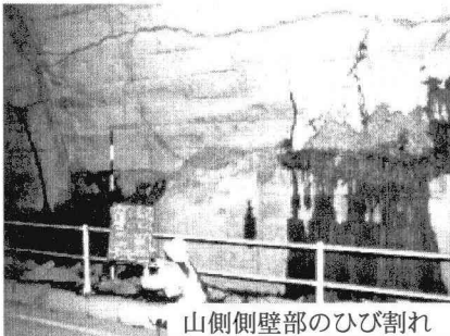
山側側壁部のひび割れ
