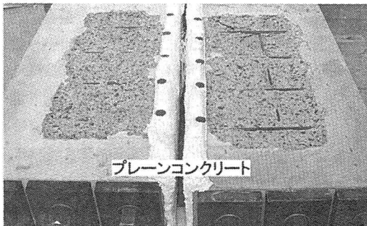
写真-13 爆裂したプレーンコンクリート
