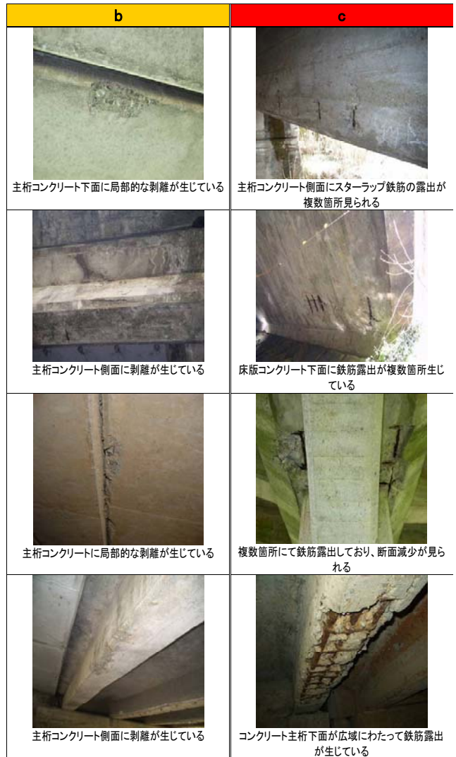
図-3 各部材の損傷度判定事例
