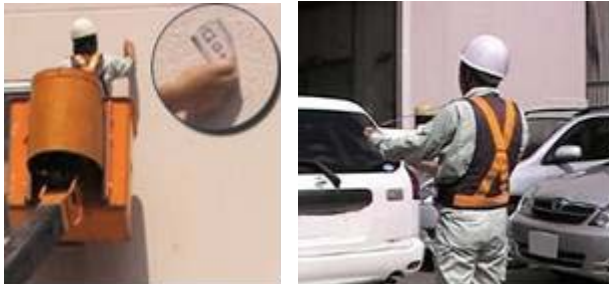
現行の点検作業 円内はクラックゲージ 現行の記録方法 スケッチブックに記録
