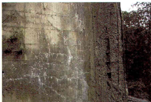
写真-1 橋台の損傷状況
