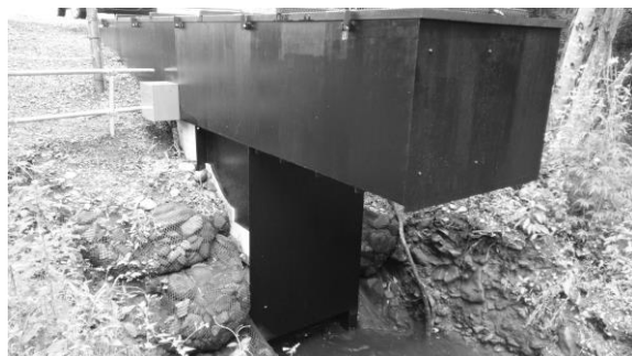
図3 小水力発電2号機。筐体内に発電機があり、下部排水口から下流に放水している。
