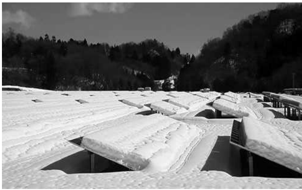
写真-6 降雪に埋もれたソーラーパネル（参考）
