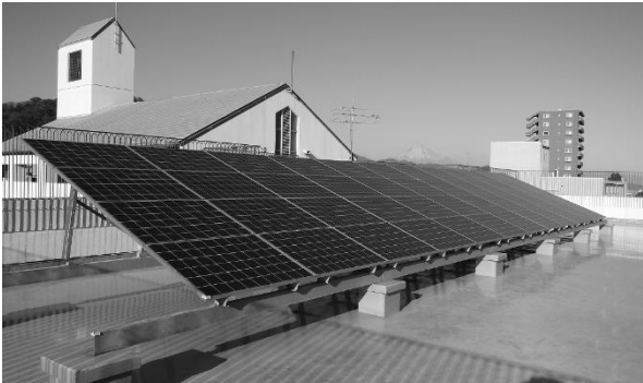
写真-1 導入されている太陽光パネル
