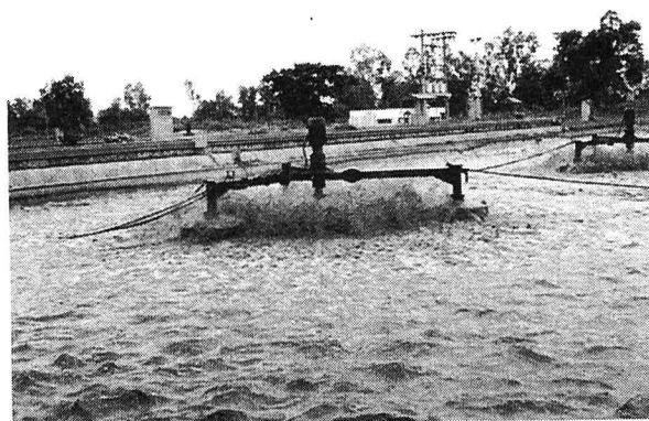
写真4 ナバナコン工業団地内の活性汚泥処理装置
