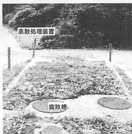
写真2 腐敗槽と蒸散処理装置
