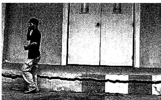
写真3 地盤沈下による大きなひび割れ (チュラロンコン大学にて)
