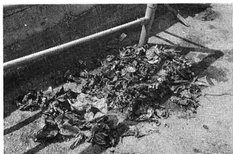
図-11 フード井につまったビニール類
